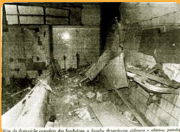
Banheiro da ABI após explosão (atentado de 1976)
